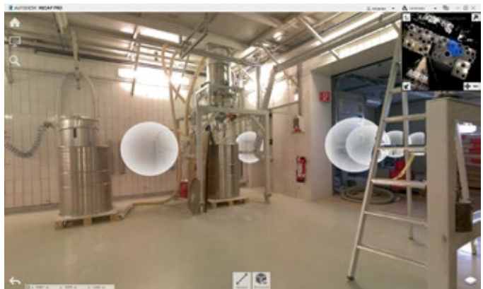
Beim Scannen entsteht außer der Punktwolke auch eine komplette Bilddokumentation mit 360° Bildern
