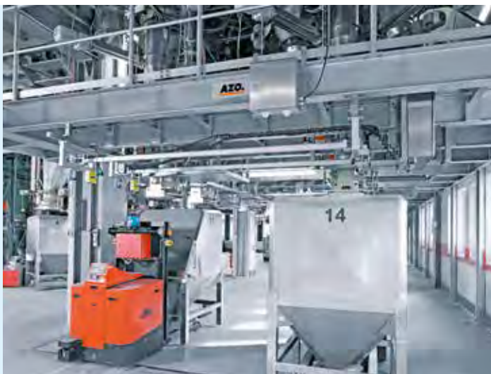
Zwischenbühne mit Waagen, die von den FTS Fahrzeugen rezepturgesteuert angefahren werden
