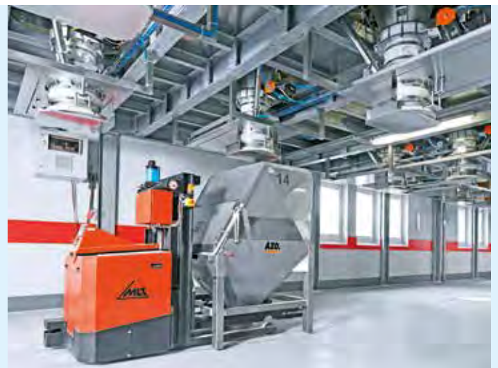
Andockstelle unter den Waagen mit Rieselschutzschieber
