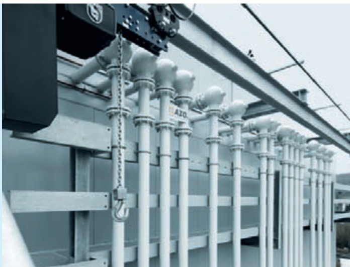
Verschleißmindernde Kugelbögen in den Befüllleitungen reduzieren die Austauschintervalle
