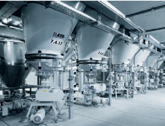
Tagessilos, ausgestattet mit Vibrationsböden und Austragsschleusen, und zum Teil mit nachfolgenden Wirbelstrom-Siebmaschinen
