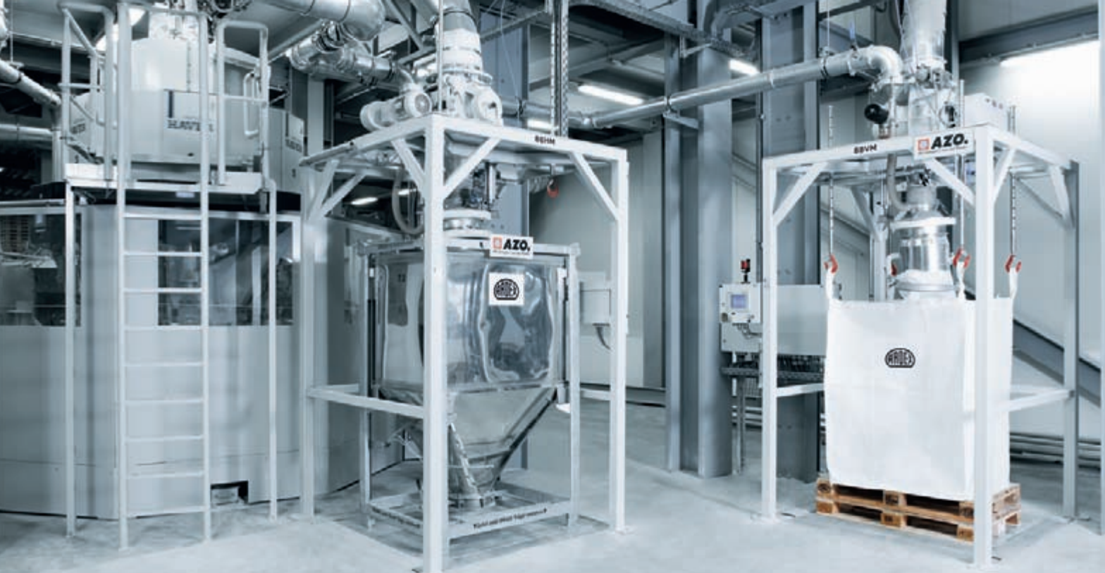
Abfüllanlage für Container und Big-Bags
