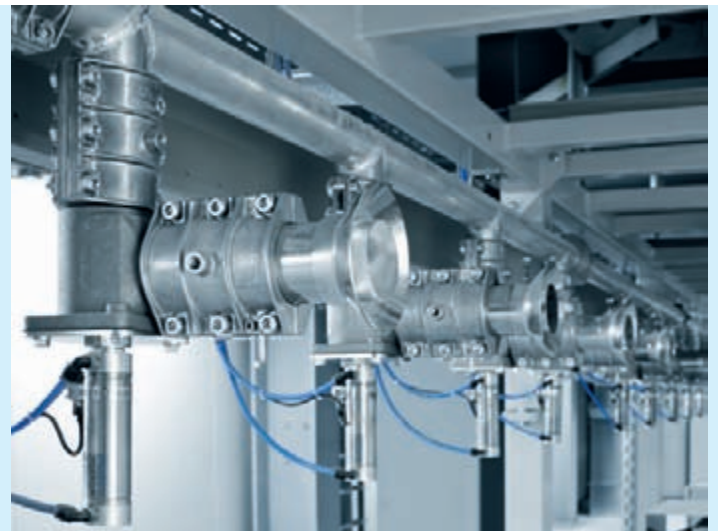
Automatische Andockung an die Besaugung der Waagenbehälter
