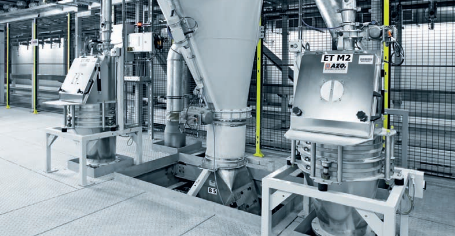
Einfülltrichter direkt über den Mixern für Handzugaben
