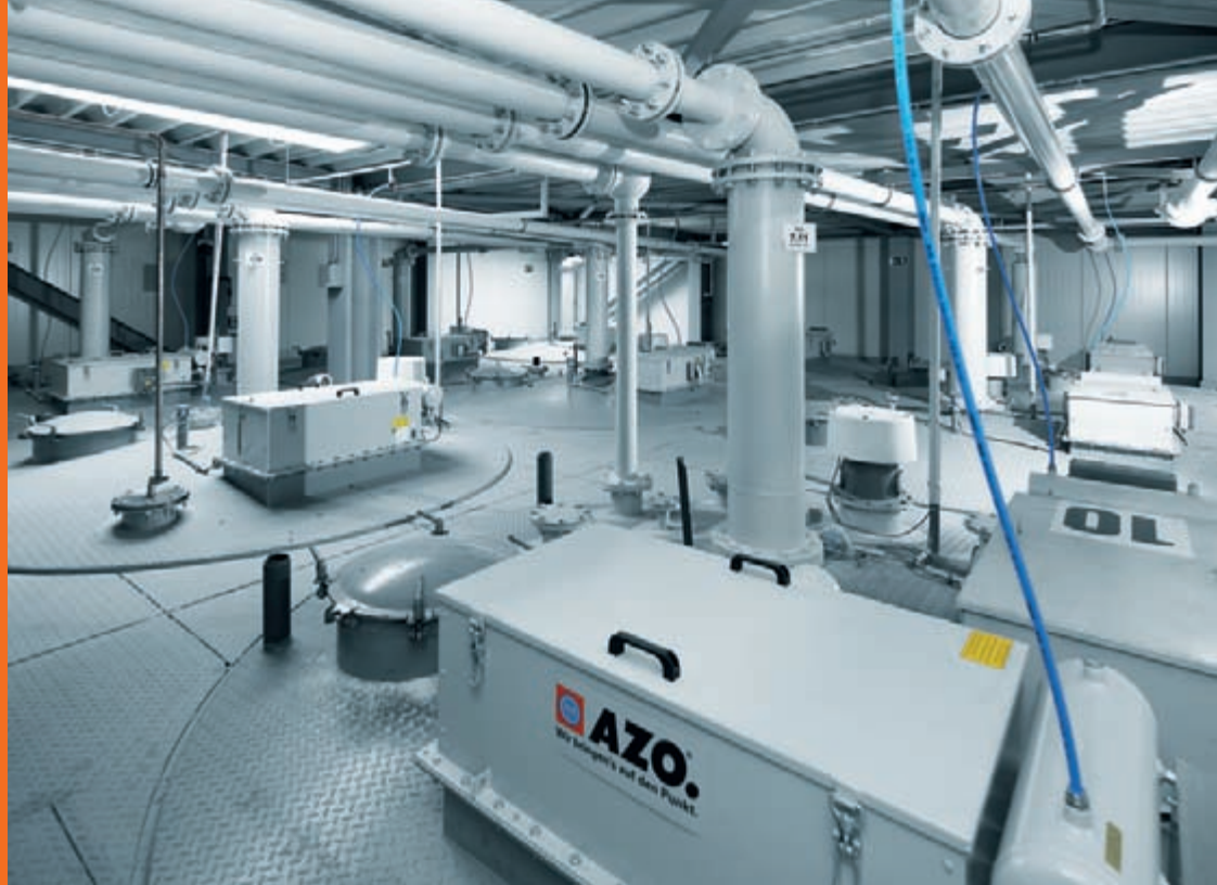
Großmengensilos mit Befüllleitungen und Filtern
