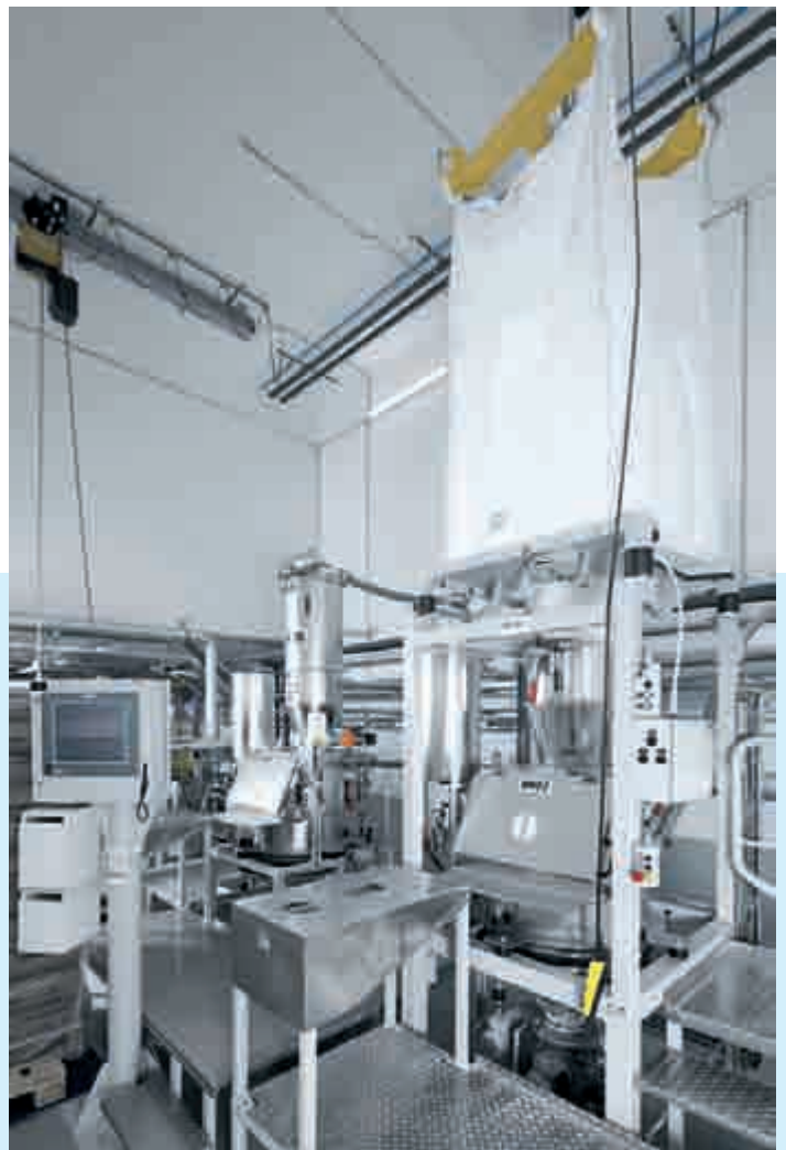
Big-Bag Entleerstation mit integriertem Einfülltrichter und zentraler Besaugung
