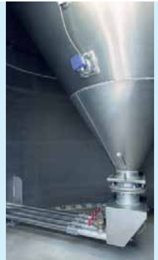
Absaugtopf mit vier Abgängen in der Silostandzarge
