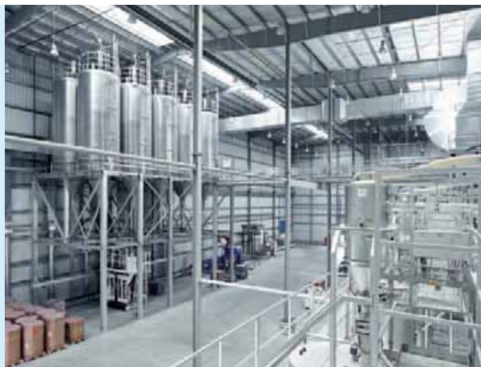
Innensilos mit Fertigware zum automatischen Absacken und Palettieren
