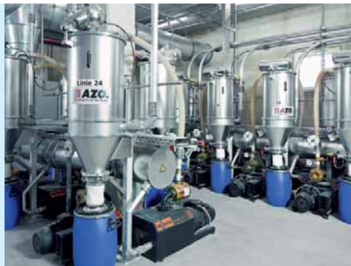
Vakuumpumpen mit vorgeschalteten Sekundärfiltern in separatem Gebläseraum
