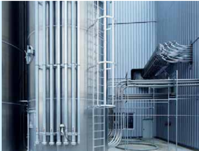
Silobefüllleitungen mit Tankwagen-Kupplungen
