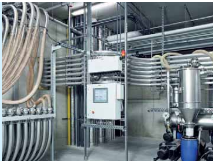
Manueller Kupplungsbahnhof zur Wegstellung von den Außensilos zu den Compoundierlinien
