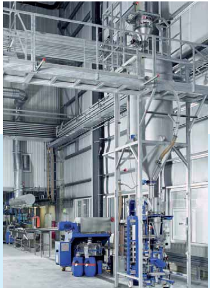
Extruderstrecke mit Granulator, Sieb und Wendekühler sowie einem Tagessilo mit Absackanlage
