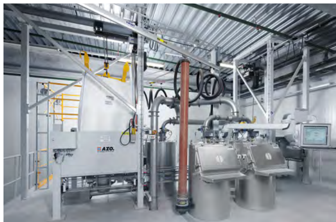
Aufgabe der Rohstoffe über Einfülltrichter und Big-Bag Entleerstationen im oberen Stockwerk
