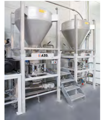
Aufgabestation für Wechselcontainer
