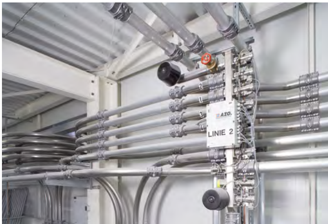
Patentierte Ventilweichen bringen die Rohstoffe auf den Punkt
