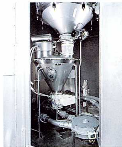
Einschleusung in Druckpneumatik mit Schleusenzulauftrichter und EntlüftungsfILTER
