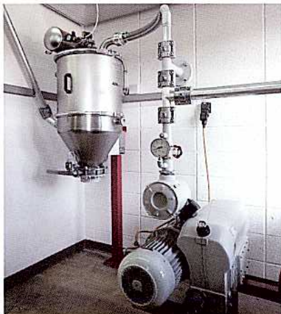
Vakuumpumpe mit vorgeschaltetem Sekundärfilter
