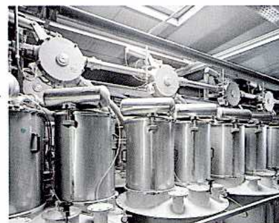
Verteilung über Rohrweichen in Innensilos
