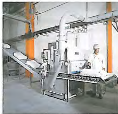
Aufgabestation mit Sackreinigung
